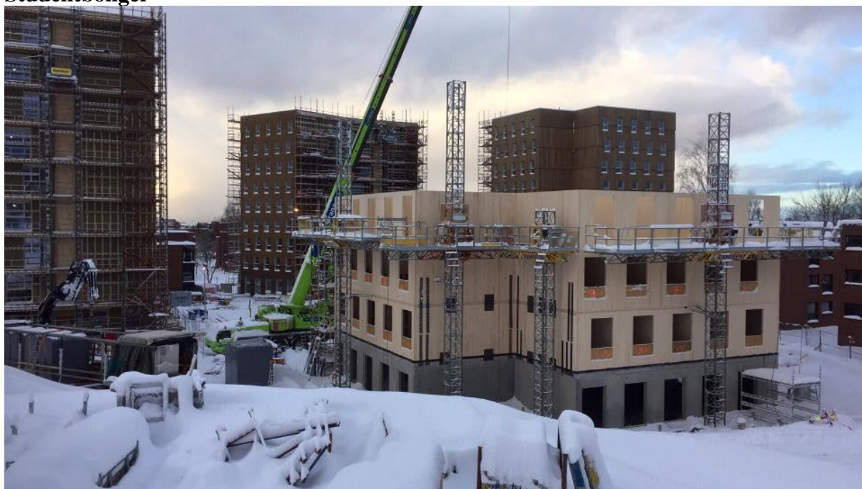
Bilde 1 Tårn C – massivtremonasje, tårn D, B og i bakgrunnen (fra venstre mot høyre). 20.01.16.
