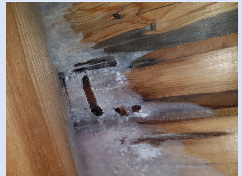
Den här bilden visar en fuktskadad vind där blött virke har utsatts för köld och frost har bildats. Frost på vinden kan även synas till vid skador som uppstått från fukt inifrån bostaden.
