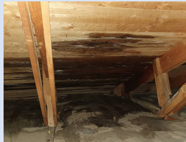
På bilden syns skador som uppstått genom att vatten trängt in genom den yttre taktäckningen, vilket lett till fuktskador i underlagstaket.
