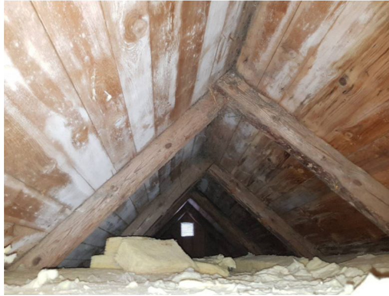
Bilden visar en vind som har drabbats av konvektionsskador på underlagstaket. Skadorna syns i form av mikrobiell påväxt/mögel.
