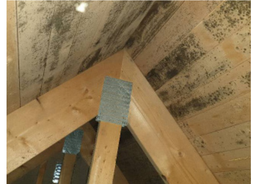
Även denna vind har drabbats av fuktproblem. Varm inomhusluft har läckt in från bostaden och mött den kalla luften på vinden. På vindens underlagstak syns svarta prickar som är en mikrobiell påväxt.
