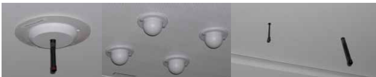
Figur 3.8. Typiske innendørsantenner for akuttmedisinsk varsling, WLAN og antenner i vaktentral.
