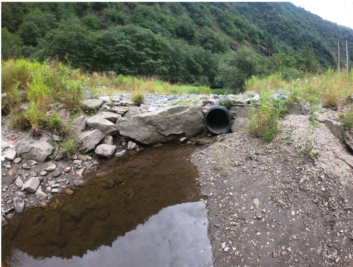
Figur 14: Kulverten som sperrer løpet i som renner inn i Mestadvatnet. Kulverten ligger plassert lengst oppstrøms i løpet, vist som det blå polygonet merket "fjerning av kulvert" i Figur 15.
