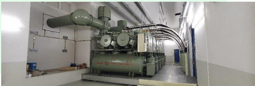
Bilde av et typisk SF 6 -anlegg.
