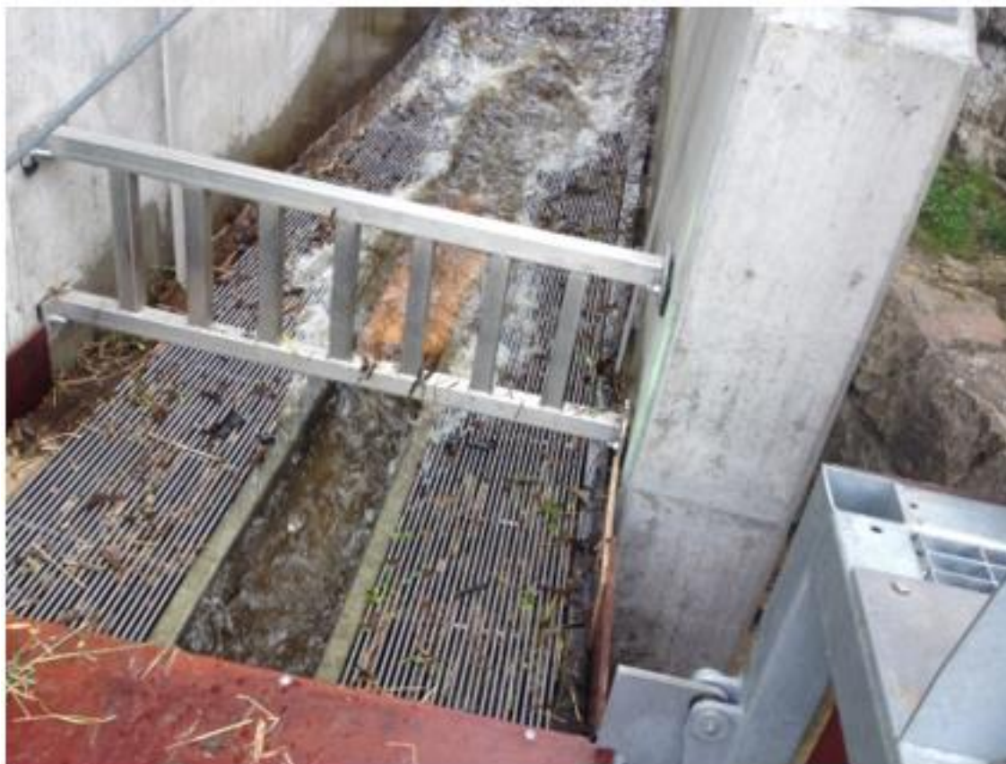
Figur 4-4. Finrist i fiskeavlederen ved Herting kraftverk i Ätran. Formålet med rista er å skille ut nedvandrende fisk fra vannet, ved at fisken sklir oppå rista ned i en oppsamlingsrenne som føres til et oppsamlingsbasseng. Foto: Norconsult Sverige.
