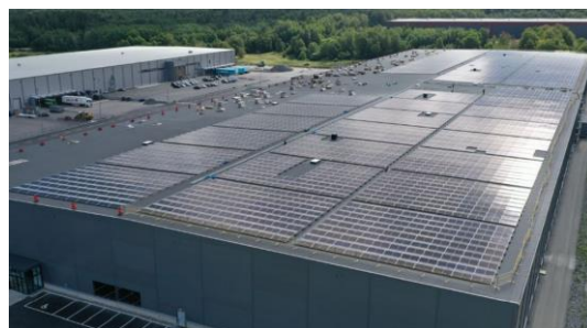
Nordens största solenergianläggning på tak som byggs för Castellum Hisingen Logistikpark i Göteborg.
