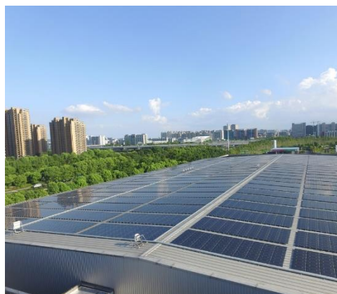
Solcellsinstallation i Kina. Källa: Advanced Soltech
