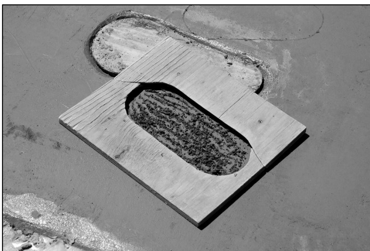
Moule en bois artisanal pour repose-pieds placé sur une dalle (Crédit : Lifewater, 2009)
