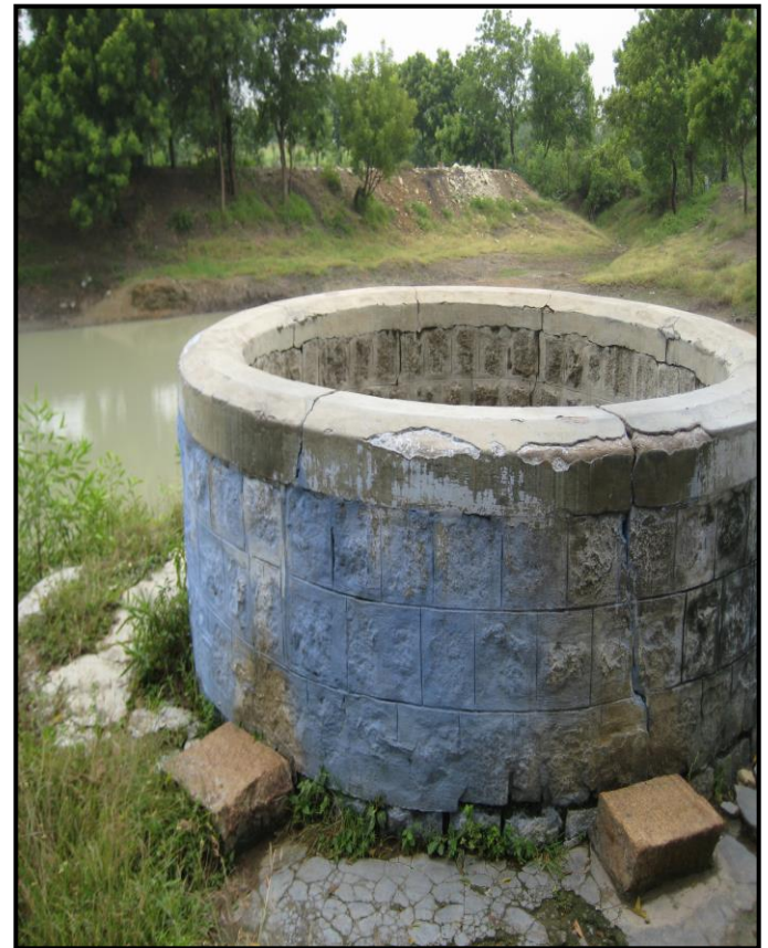
Pozo no protegido
