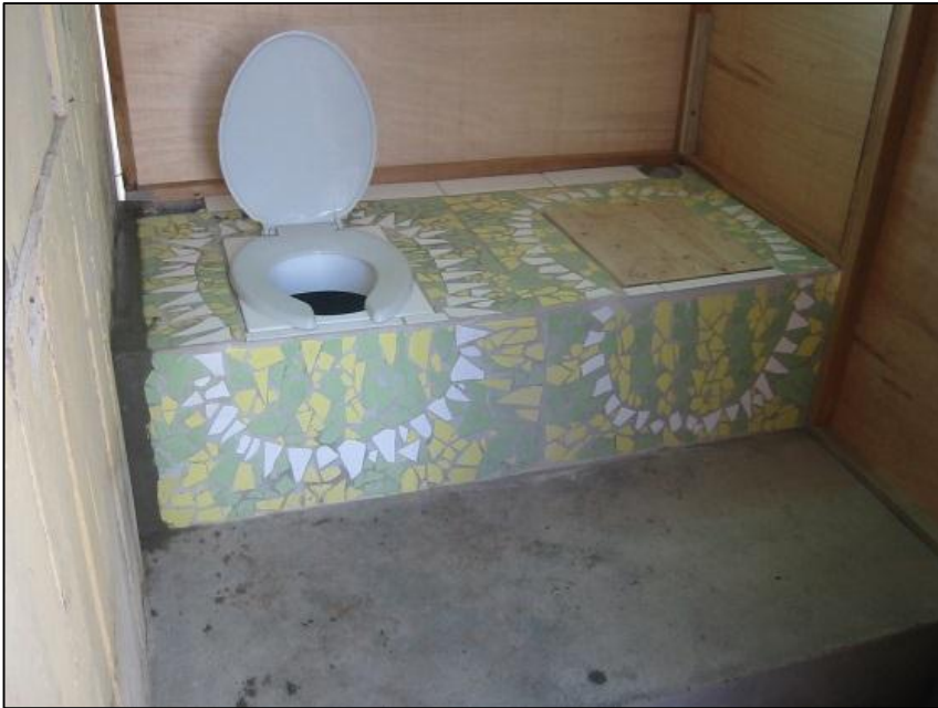
Inodoro de deshidratación con diversión de orina - Perú
