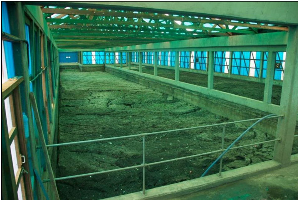
Dos tanques de asentamiento y espesamiento en Kampala, Uganda (Fuente: Lars Schoebitz)
